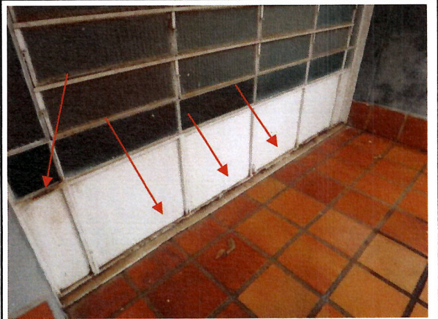
Foto 10 – Sinais de ferrugem nas esquadrias do abrigo de veículos
