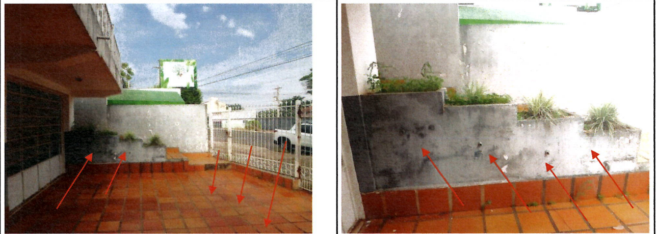
Fotos 05 e 06 – Mureta da escada/floreira com infiltrações e trincas no piso frontal
