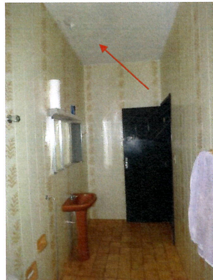
Foto 30 – Sinais de umidade no teto dos banheiros dos apartamentos
