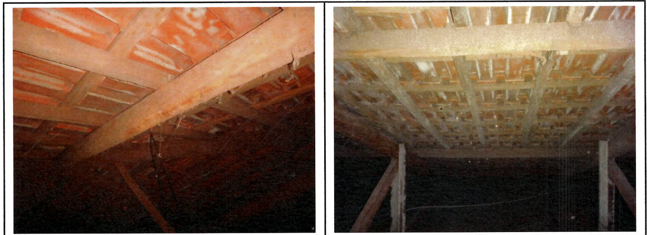
Fotos 37 e 38 – Terças danificadas, possivelmente atacas por brocas ou cupins
