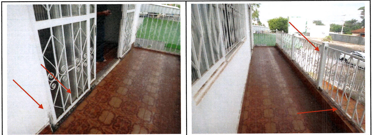
Fotos 23 e 24 – Sinais de ferrugens nas esquadrias e no guarda corpo da sacada
