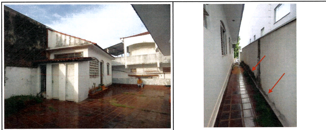
Fotos 17 e 18 – Fissuras no piso posterior e infiltrações no muro lateral esquerdo
