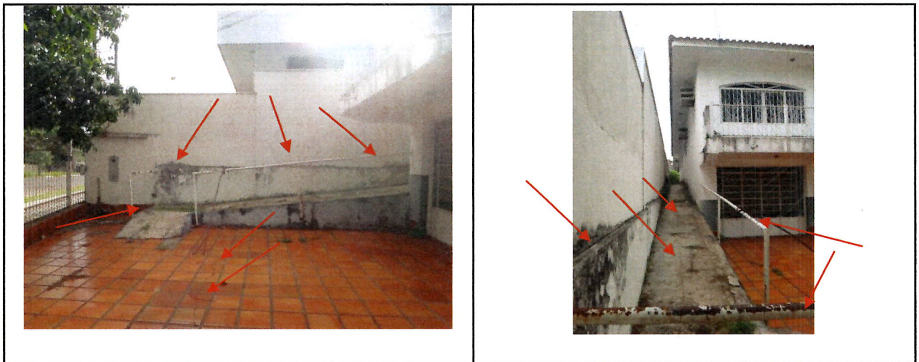
Fotos 03 e 04 – Rampa e corrimão em desacordo com a NBR 9050, infiltrações no muro e trincas no piso
