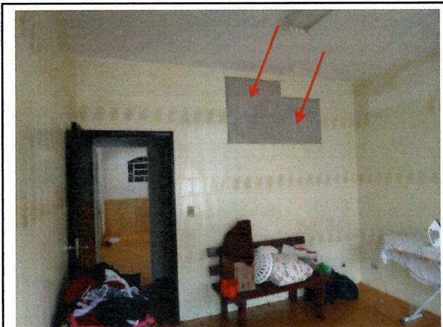
Foto 25 – Destacamento de azulejos no quarto dos fundos, atualmente utilizado como extensão da lavanderia
