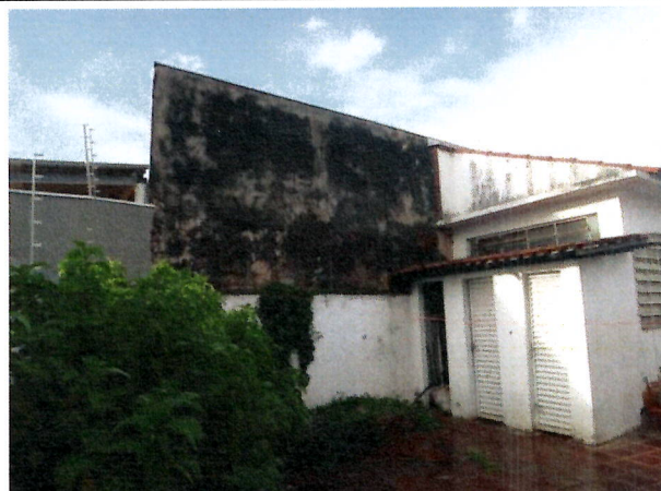
Foto 44 – Depósitos junto à edícula (não constam no projeto de arquitetura)
