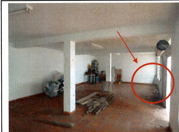
Foto 07 – Vista geral do abrigo de veículos, no detalhe pontos de infiltrações
